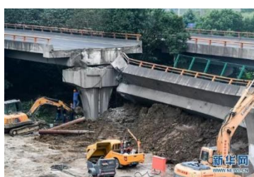
(a)江苏高架桥垮塌
